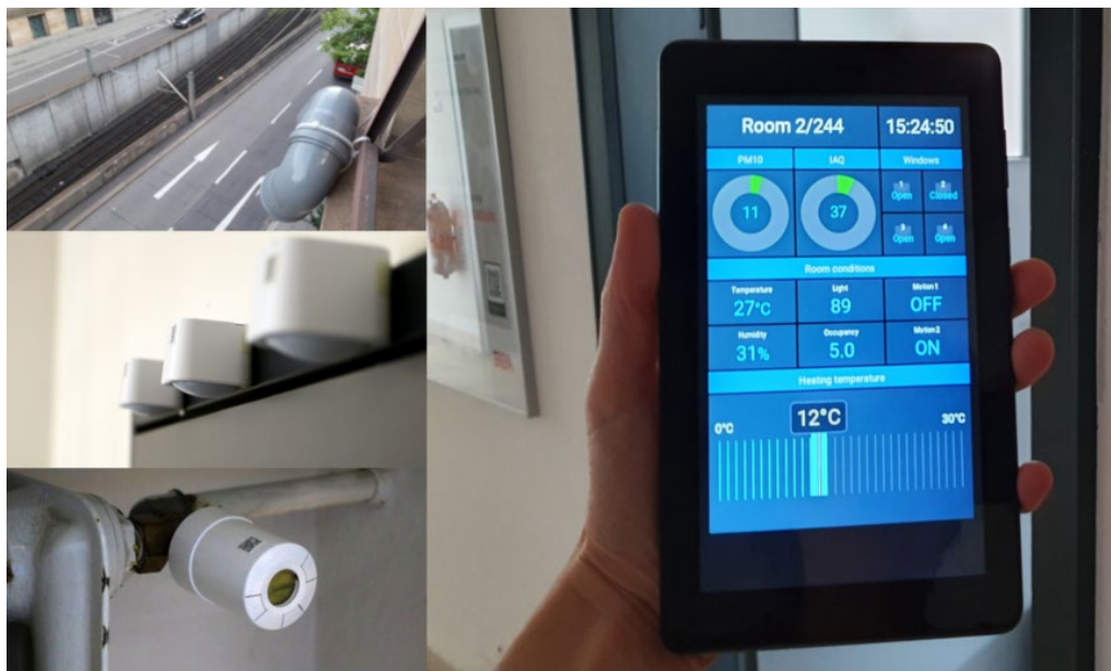
Abbildung 29: Smart Public Buildings - Feinstaubsensor, Multisensor und smartes Thermostat; User Interface (basierend auf dem HABpanel von openHAB) zur Darstellung und Steuerung der Geräte auf einem Tablet.
